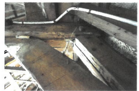
6: Gesneden telmerken (II) op een eiken juk in de constructie van het voorhuis van Koepoortstraat 31. FH MAB jan 2020.
